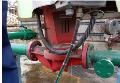
FIGURE 2 : FUITE D'EAU PROVENANT D'UN CARTER ROUILLÉ, SANS REVÊTEMENT PAR ÉLECTRODÉPOSITION
